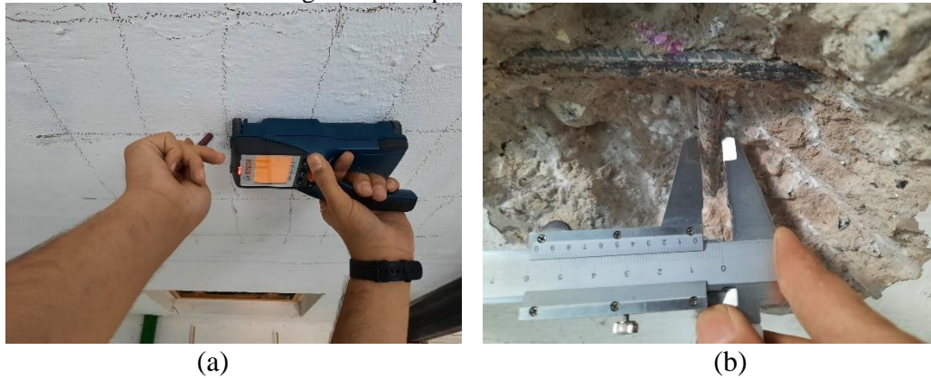
Figura 5 – Mapeamento das fissuras
