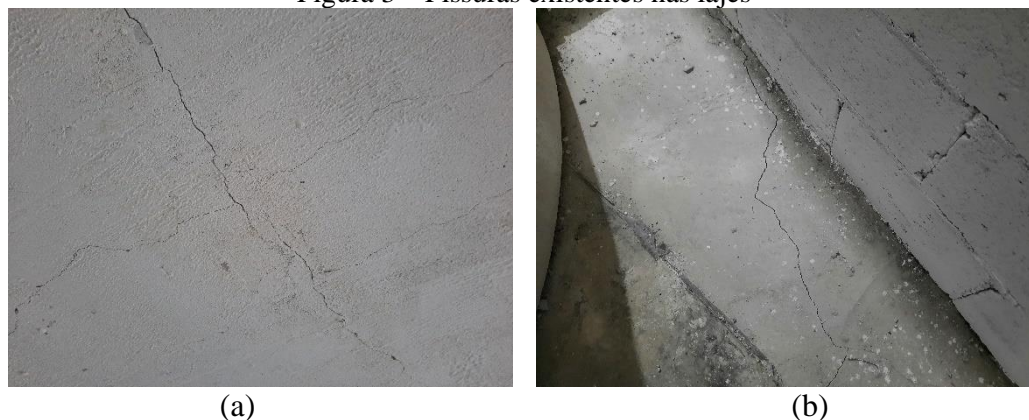
Figura 3 – Fissuras existentes nas lajes
